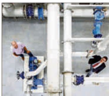
Leiter Gas und Wasser Hans Tobler und Geschäftsleiter Jürg Flückiger im Reservoir Bühholz. Bild: zvg
